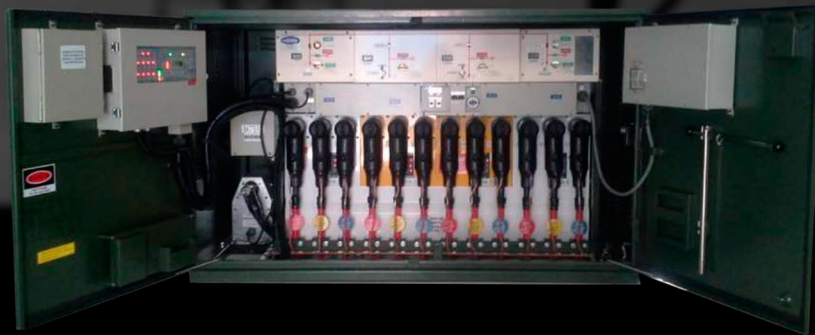
Seccionador Tipo Pedestal
